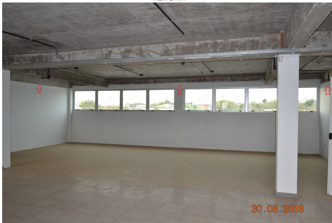
Foto 3 - Nas vigas (onde consta a seta vermelha, por exemplo), aplicar os revestimentos (chapisco e emboço) para que a parede fique toda no mesmo nível e prumo
